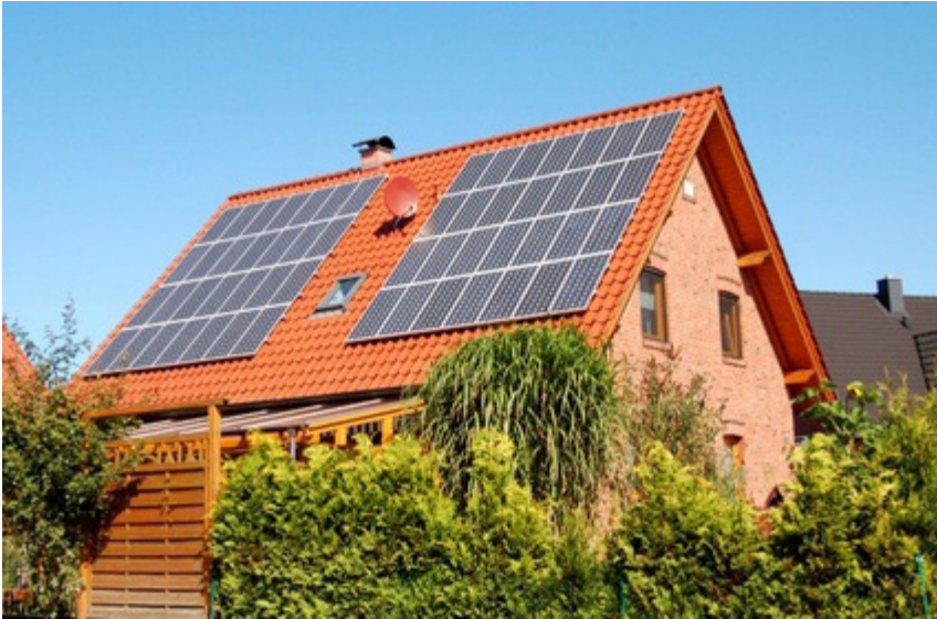
Abbildung 46: Photovoltaikanlage für ein Einfamilienhaus
