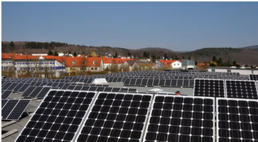
Abbildung 47: Photovoltaik-Anlage am Dach der Firma Garreis
