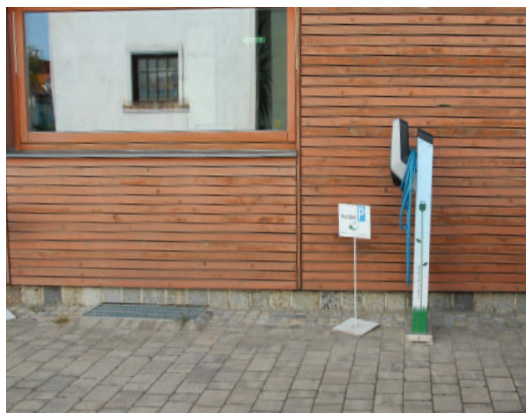
Abb. 7.22: Elektroladestation für Fahrzeuge. eigene Aufnahme
