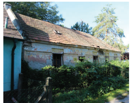
Abb. 7.28: altes baufälliges Haus. eigene Aufnahme
